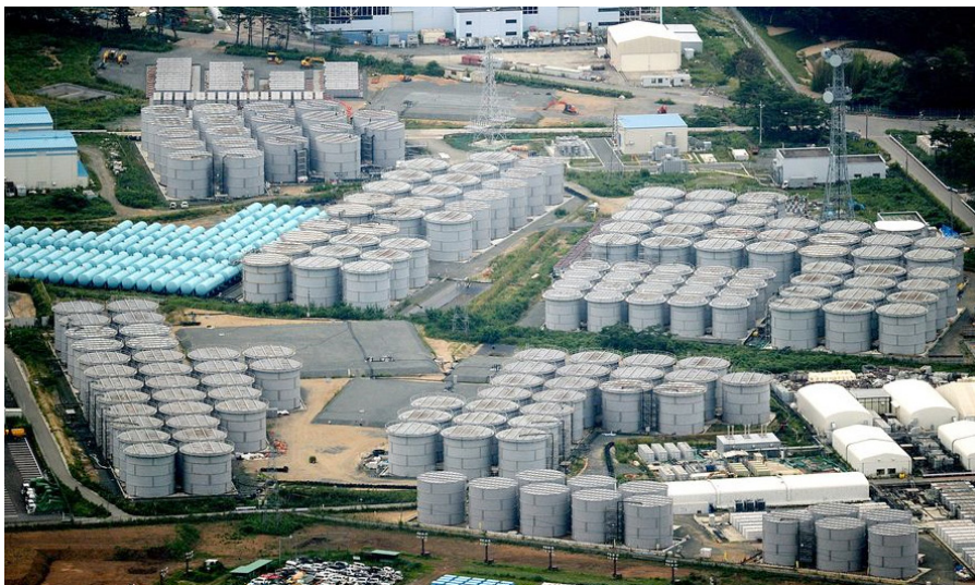
Tankar fyllda med radioaktivt vatten med bland annat tritium. Foto: TEPCO.
